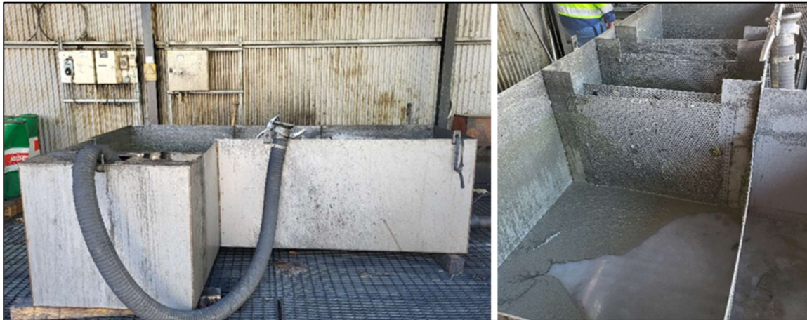
Figur 5. Öppen tank med grovfilter.
