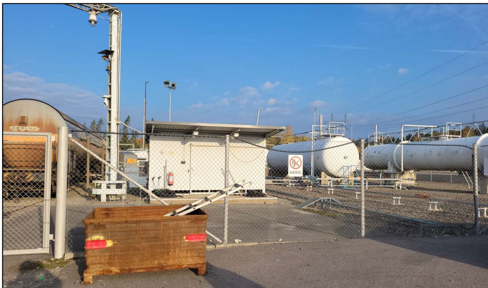
Figur 12. Anläggning för lagring av gasol.
